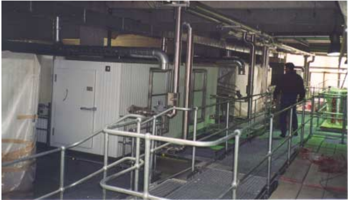
Isolierkühler TK Zwischenlager Aldi
