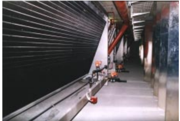
Bild 2: Ansicht auf 50% der installierten 8 Kühler von der Lufteintrömseite her gesehen. Die Kühlluft wird über die rechts im Bild sichtbaren Kulissenschalldämpfer angesaugt und horizontal durch die Kühler geführt.
