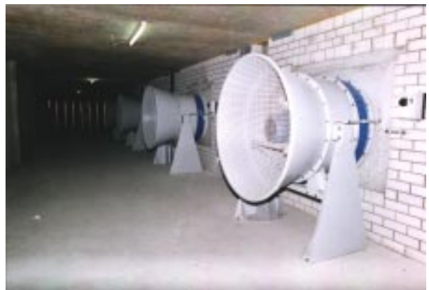
Bild 3: Jedem Kühler ist ein Ventilator zugeordnet, dessen Totalwirkungsgrad über 85% liegen musste. Mit Diffusoren gelang es, diesen bis auf 89,3% zu bringen. Im Hintergrund erkennt man die Ausblas-Schalldämpfer vor dem Steigschacht.
