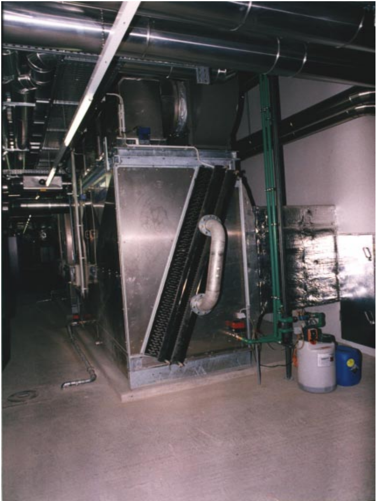
Bild 5 Aufstellung eines hybriden Trockenkühlers mit Doppelkühlelementen und Radialventilatoren in einem Technikraum einer Druckerei. Vorne rechts erkennt man noch die Dosierstation für die Nachbehandlung des Zusatzwassers. Je nach Wasserqualität wird ein Kombinationsprodukt für die Härtestabilisation und mit einem Korrosionsinhibitor geimpft.
